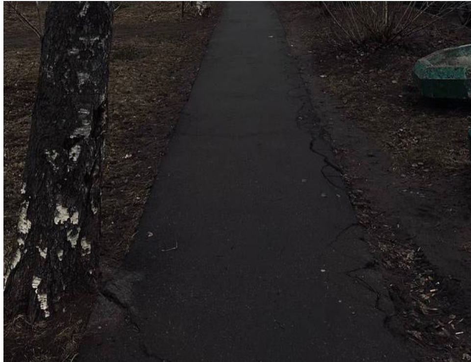
Необходима замена покрытий
